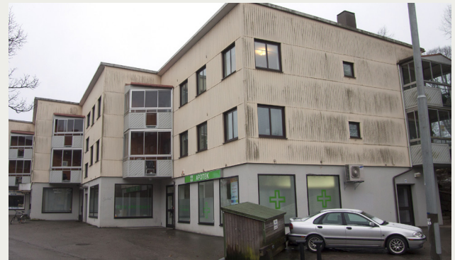
Figur 3. Byggnad med plåtfasade där det på fasaden åt norr finns kraftig missfärgande påväxt, medan fasaden åt öst saknar sådan påväxt.
